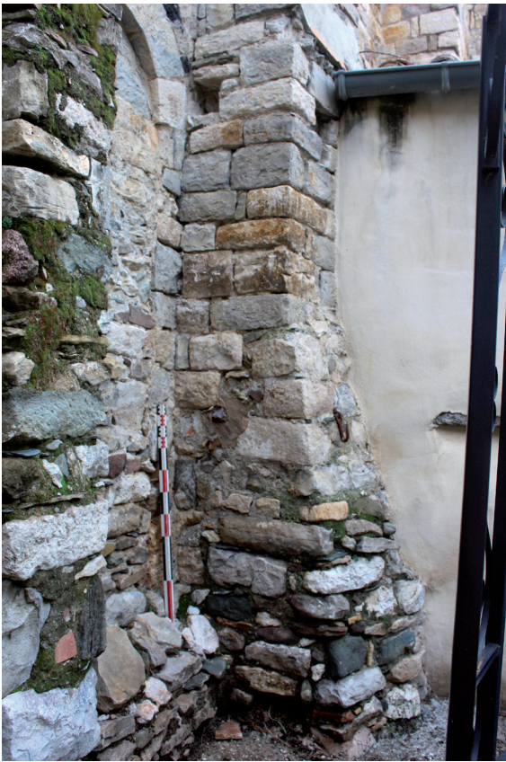
Fig. 32. Le contrefort est, avec un arrachement vers le sud. (cliché : M. Charrie-Adrian)
