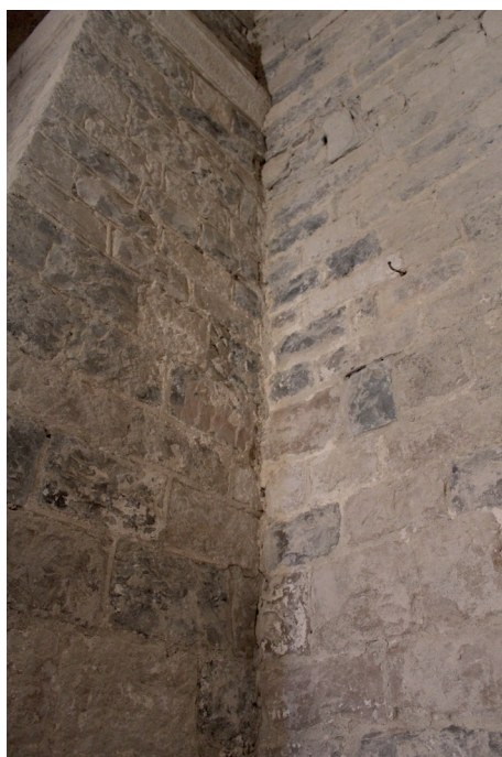
Fig. 36. L'articulation entre le support de l'arc triomphal (à gauche) et la nef (à droite) : la nef semble partiellement démontée pour favoriser un pseudo-chaînage, visible surtout dans les parties basses contre le massif.
